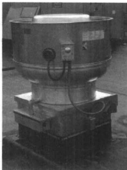
شکل (۱۴-۵-۲۰) هواکش تخلیه پشت بامی
